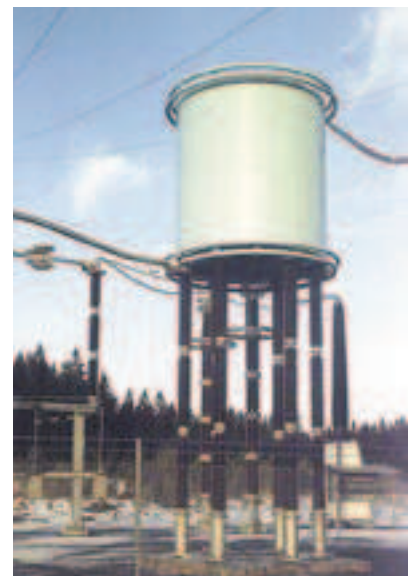
Рис.17. Высоковольтный сглаживающий реактор для линии постоянного тока
