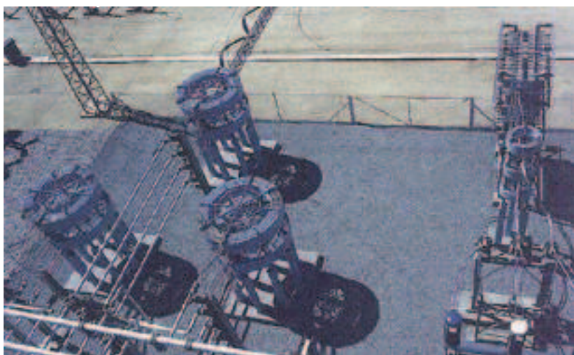
Рис.13. Шунтирующие реакторы с тиристорным управлением и фильтровые реакторы в схеме компенсации реактивной мощности
