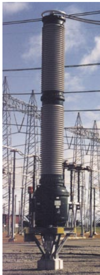
Трансформатор напряжения на напряжение 800 кВ
