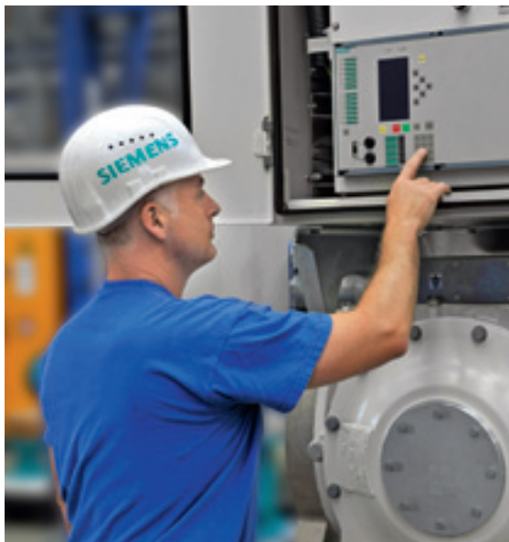
Система диспетчерского управления и защиты ячейки, размещенная в удобном в эксплуатации шкафу местного управления
